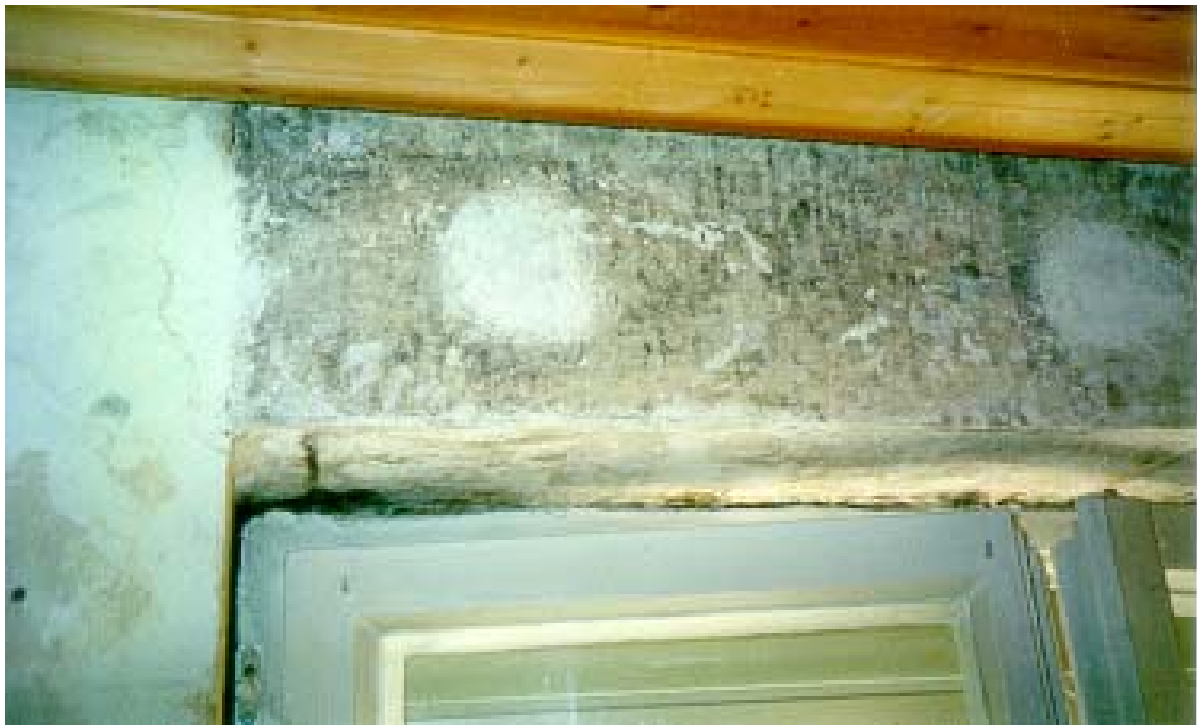
Bild 6 Stockflecken über dem Fenstersturz nach Abnahme einer punktwise verklebten Innendämmung aus gipskartonkaschierten Polystyrol-Hartschaumplatten.
